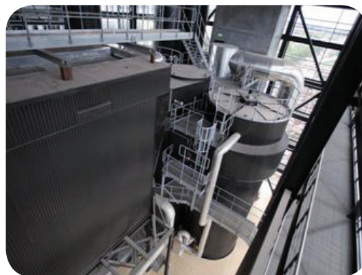
位于丹麦TAS垃圾焚烧装置中的布袋过滤器
