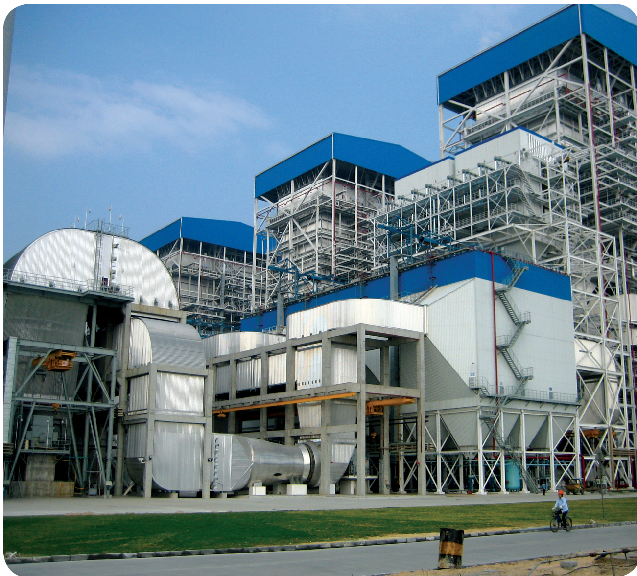
中国泰山电厂—应用了Topsoe SCR装置。SCR装置在照片中间，ESP在照片左边。 照片：Haldor Topsoe A/S
