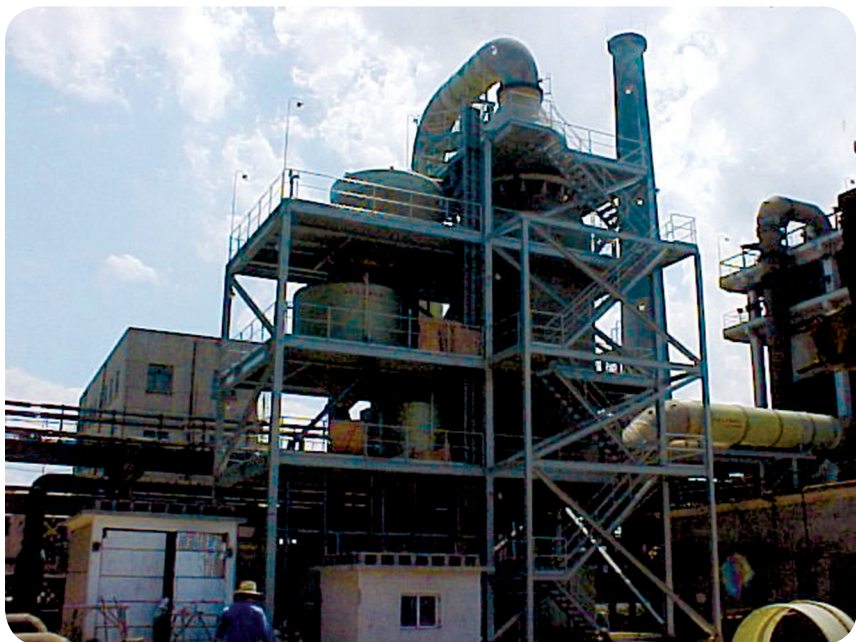
在炼锌厂中奥图泰除汞工艺装置 照片：奥图泰
