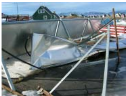
De ødelagte solfangere efter stormen i slutningen af februar 2006
