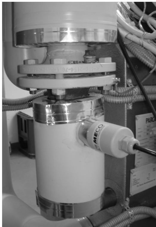
Fig. 4.4.2. The probe installation in Rantakylä.
