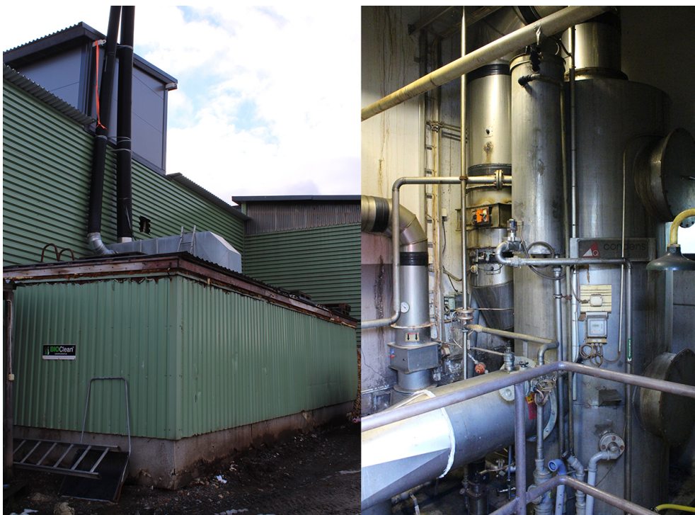
Figur 17: Biofilter (til venstre) og vådskrubber (til højre).
