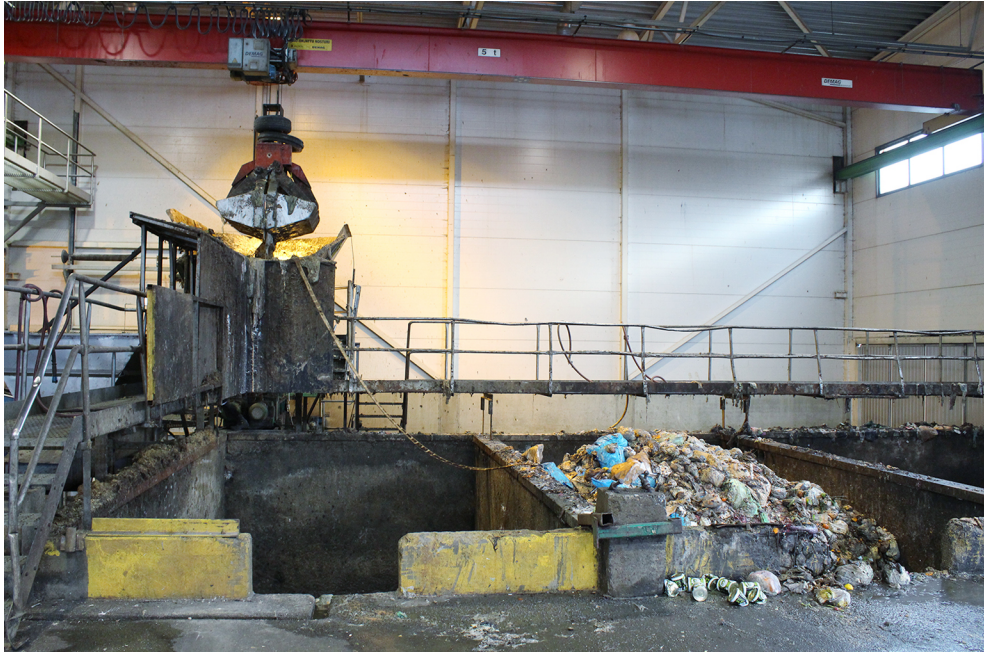
Figur 14: Indendørs modtagelse. Emballage fjernes før behandlingen i biogasanlægget.
