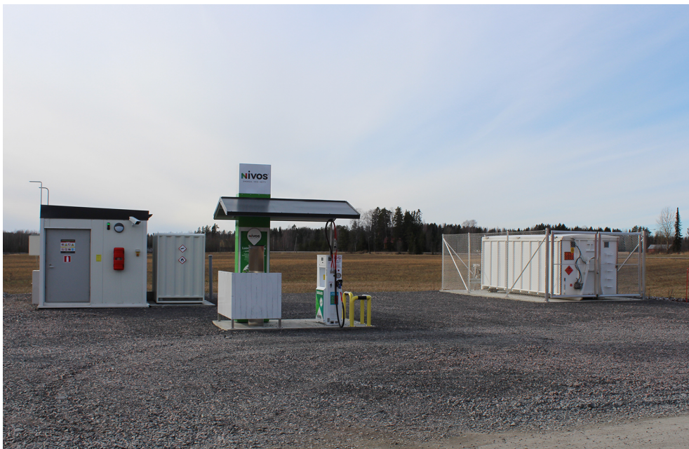
Figur 20: Eksempel på brændstoppåfyldningsstation og gaslagringsbeholder i Palopuro, Finland.
