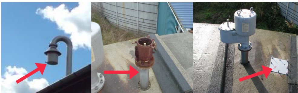
Figur 18: Eksempler på ventiler på biogasanlæg. Billedet i midten er en gammel ventil, der ikke er i funktion og lækker metan. På billedet til højre er ventilen fjernet, og hullet lukket med en metalplade, (Stefanek, Hansen, & Rasmussen, 2015).
