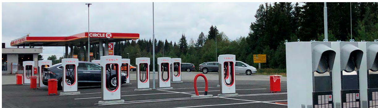
Tesla ladestasjon, Hernes. Källa: Kjell Vaagen
